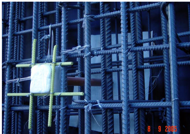
Entrada protegida de la tubería de inyección
